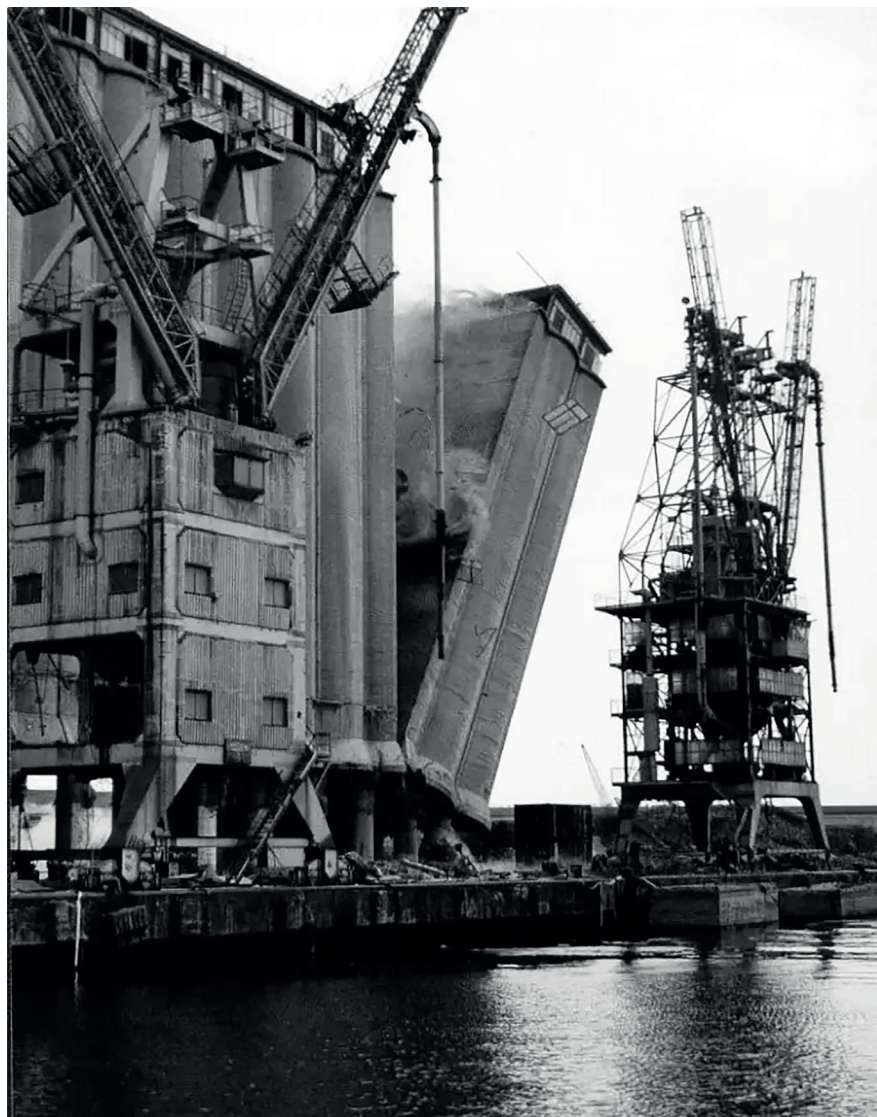
6. Demolizione dei silos granari di Ponte Parodi a Genova, 2002 (da https://www.esplosivi.it/work/2002-ponte-parodi-1-ge-ex-silos-granari/ , ultima consultazione: 18 agosto 2022).
